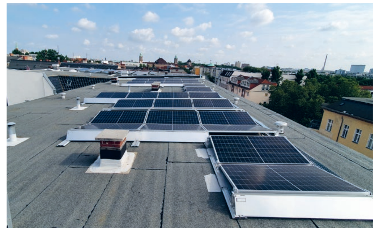
Unsere Photovoltaikanlage in der Spenerstraße/Melanchthonstraße
